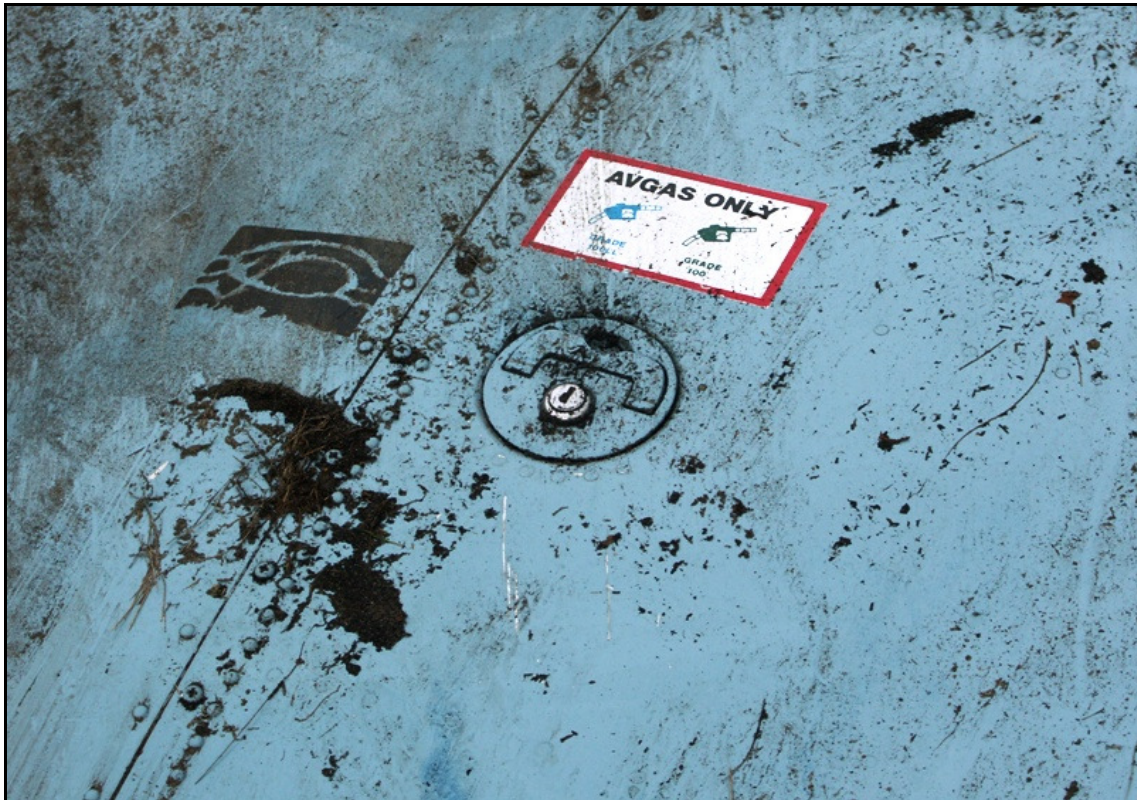
Fot. 24. Stan wlewu paliwa prawego skrzydła
