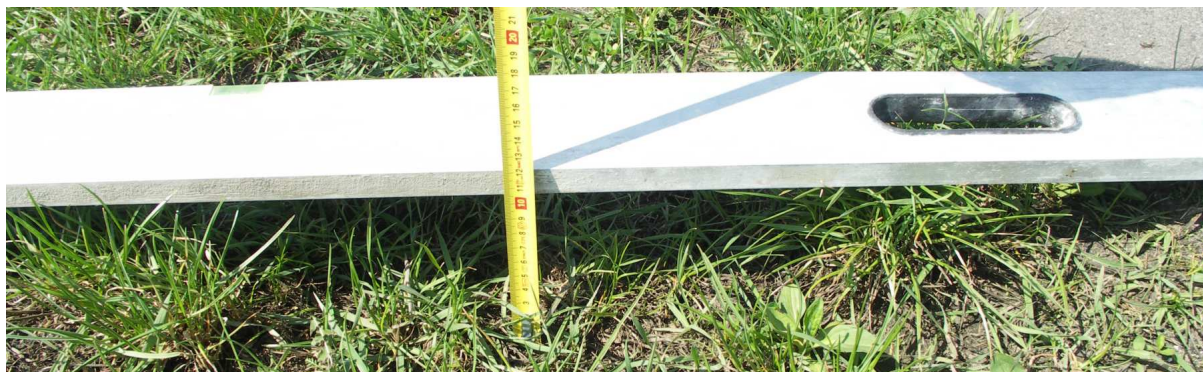
Fot.5 – Pomiar głębokości zagłębienia przy bocznym skraju drogi kołowania.
