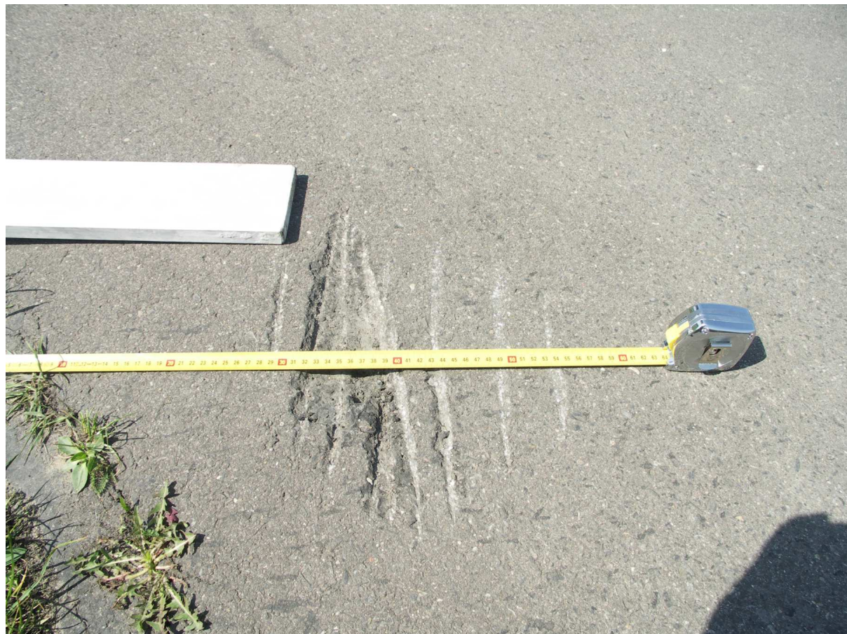
Fot.2 – Ślady łopat śmigła na asfalcie drogi kołowania przy jej bocznym skraju.
