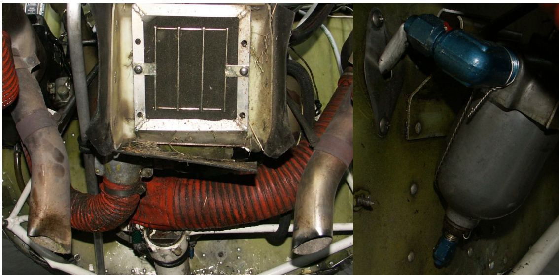
15 i 16 – Widok obudowy filtra chwytu powietrza do gaźnika i wgniętych rur wydechowych oraz przemieszczonego na odkształconym wsporniku filtra paliwa z zagniecionym (załamany) przewodem doprowadzającym paliwo.
