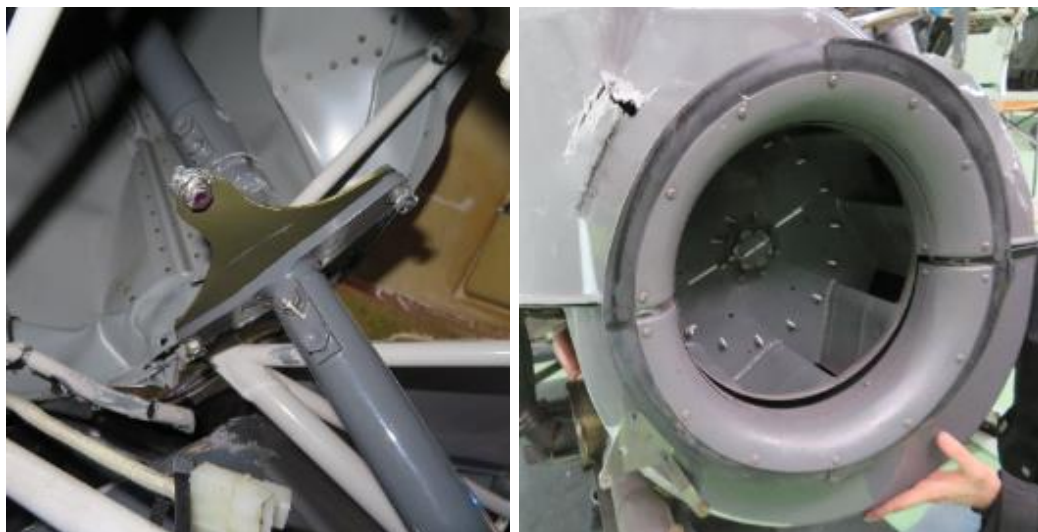
Rys. 8, 9. Pośrednia płytka podatna oraz wentylator – uszkodzenia świadczą o pracy podczas zderzenia z ziemią.
